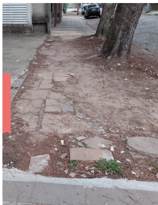
Calçada irregular Santa Maria-RS
