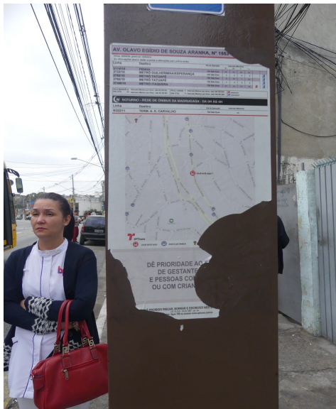
Foto 8: Ponto de ônibus sem abrigo e locais para sentar, além de sinalização danificada.
